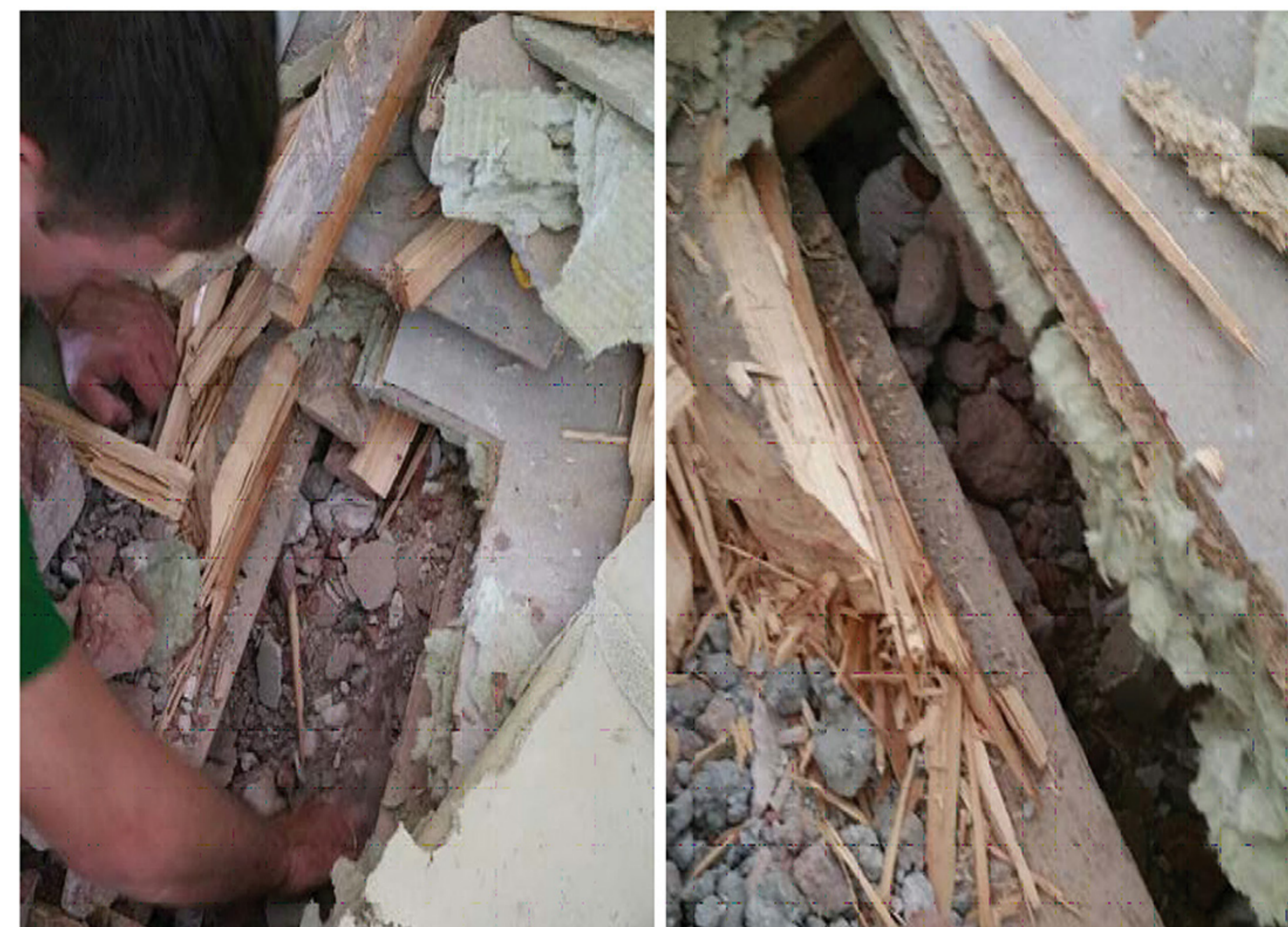
На фотографиях видны старая конструкция пола и строительный мусор под ней.
